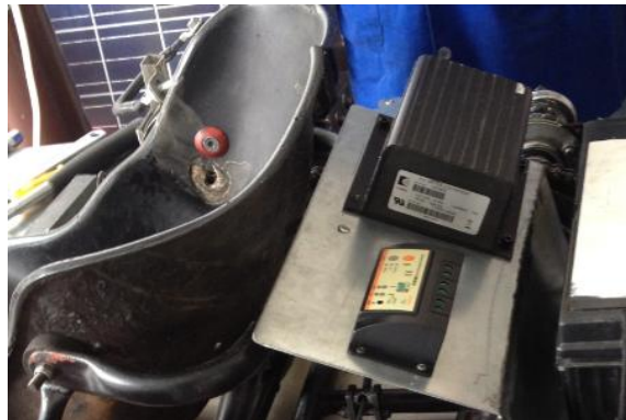
Figura 7- Suporte de fixação dos controladores.
