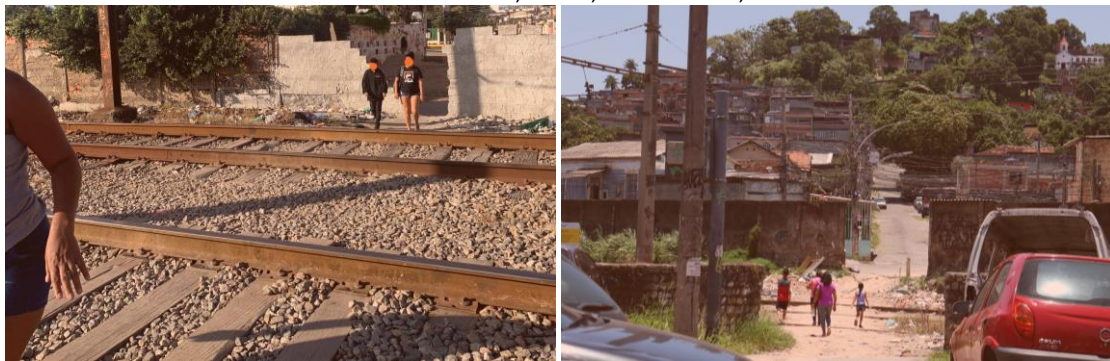
Figura 5 (Direita) – Buraco da rua Lomas Valentinas, Realengo, Rio de Janeiro, RJ. Figura 6 (Esquerda) – Buraco da rua Luis de Castro, Pílares, Rio de Janeiro, RJ.
