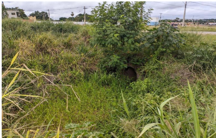
Figura 16: Tubulação no acúmulo de água próxima a rotatória.
