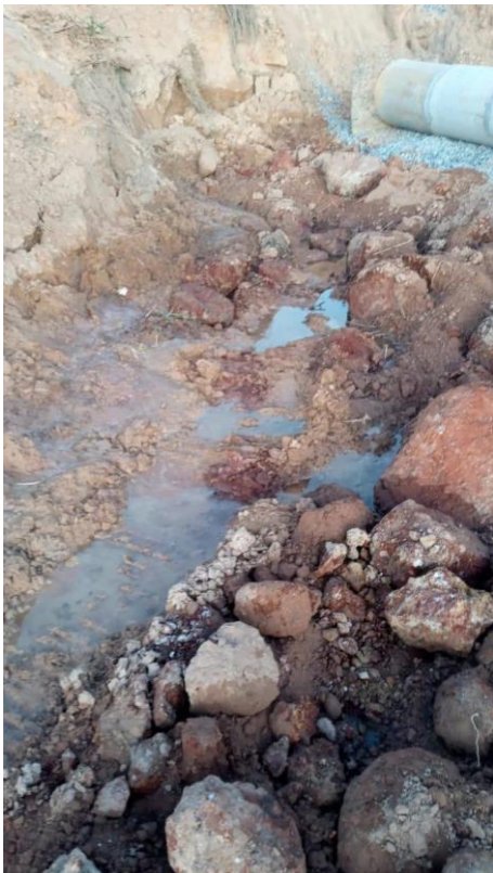
Figura 11: Água minando da parede.
