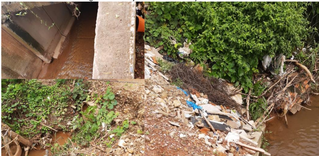
Figura 3 - Condição da Ponte e Situação de Barreira
