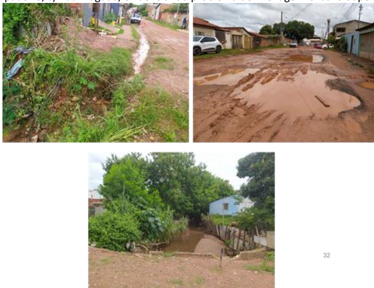
Figura 6 - Desconformidades Urbanísticas - “Bueiro Ponte” pela Prefeitura Municipal de Cuiabá; b) Manilha sem Dissipador e; c) Rua Alagada, evidenciando problema de Drenagem Urbana Superficial.
